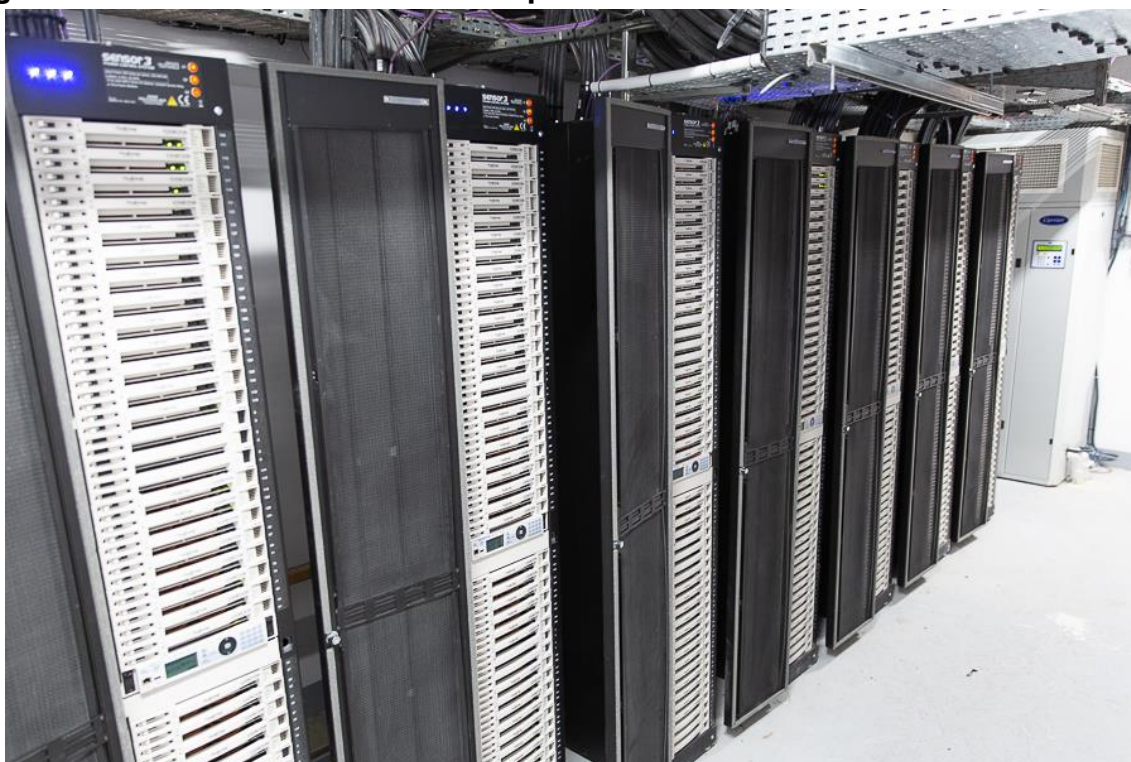
Les armoires contenant les 600 gradateurs ETC Sensor3.
