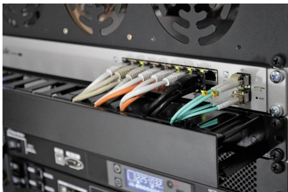
Baie réseau – Photo © Goosera
