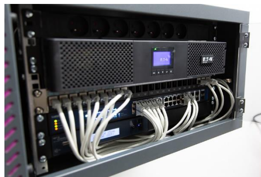
Le rack réseau installé au niveau de la salle des gradateurs.
