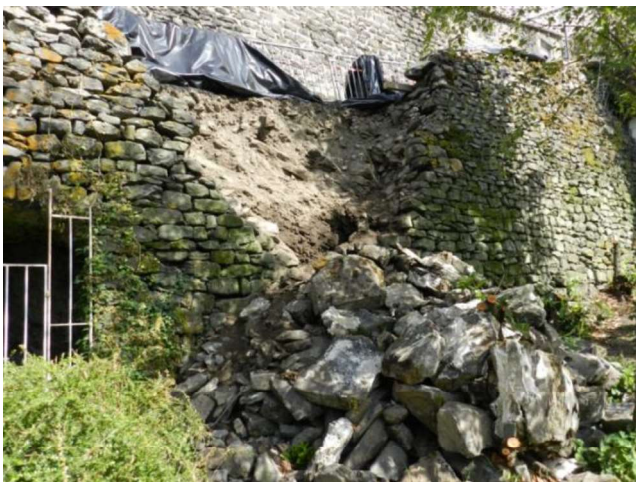
Mur effondré à la suite d'un défaut de drainage suivi d'infiltrations et d'un cycle gel/dégel
