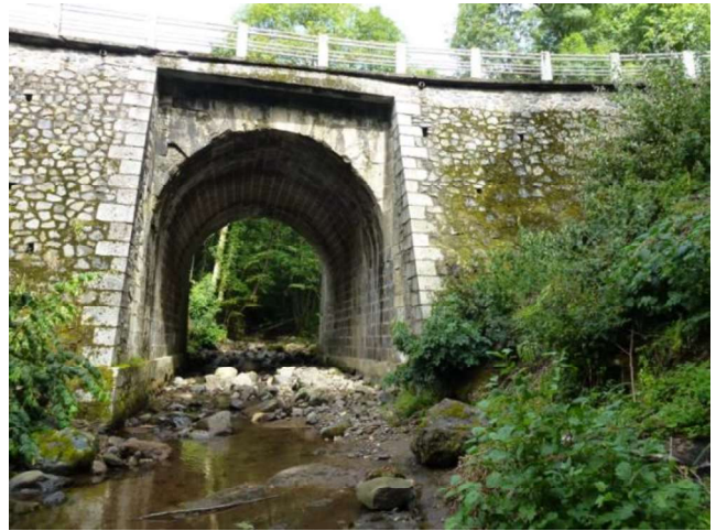
Pont en maçonnerie affecté de divers désordres : radier en mauvais état, dégradation des bandeaux et défaillance de l'étanchéité
