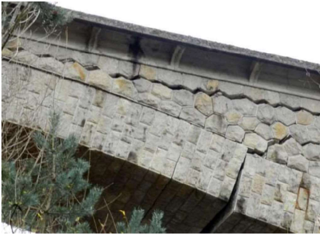
Fracture grave d'une voûte en maçonnerie. Un tel état impose de prendre des mesures de sécurité immédiates au dessus et au dessous de l'ouvrage
