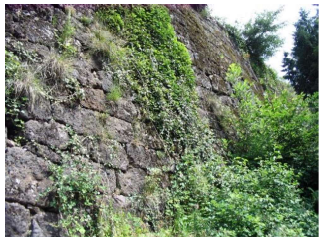
Mur de soutènement présentant des bombements et des défauts d'entretien courant
