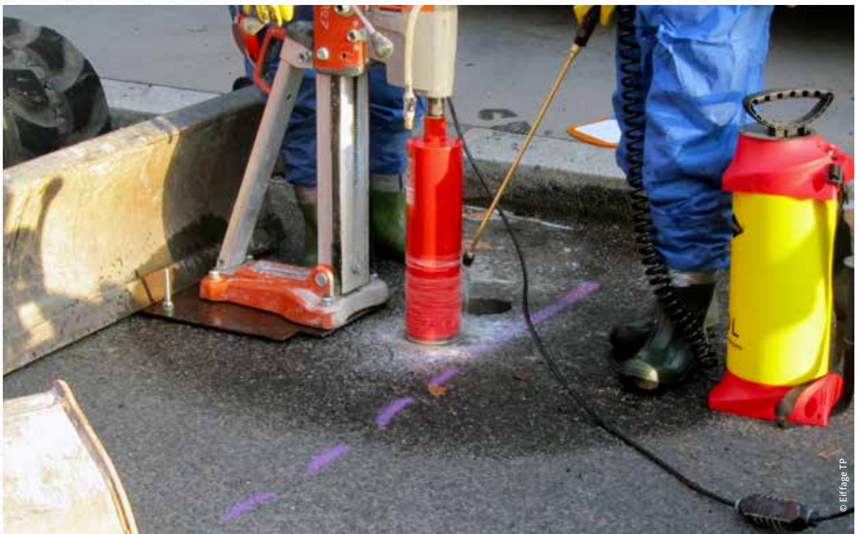
Un ouvrier effectue un carottage en vue de mesurer les HAP présents dans l'enrobé.
