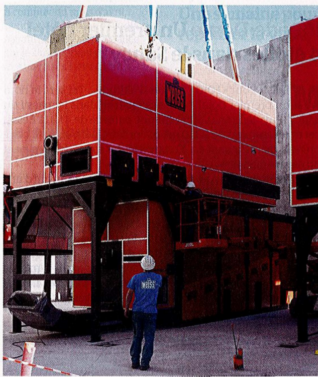
Les deux chaudières biomasse de 7 MW et 2,7 MW ont été implantées dans un bâtiment en béton, qui sera ensuite habillé de bois.
